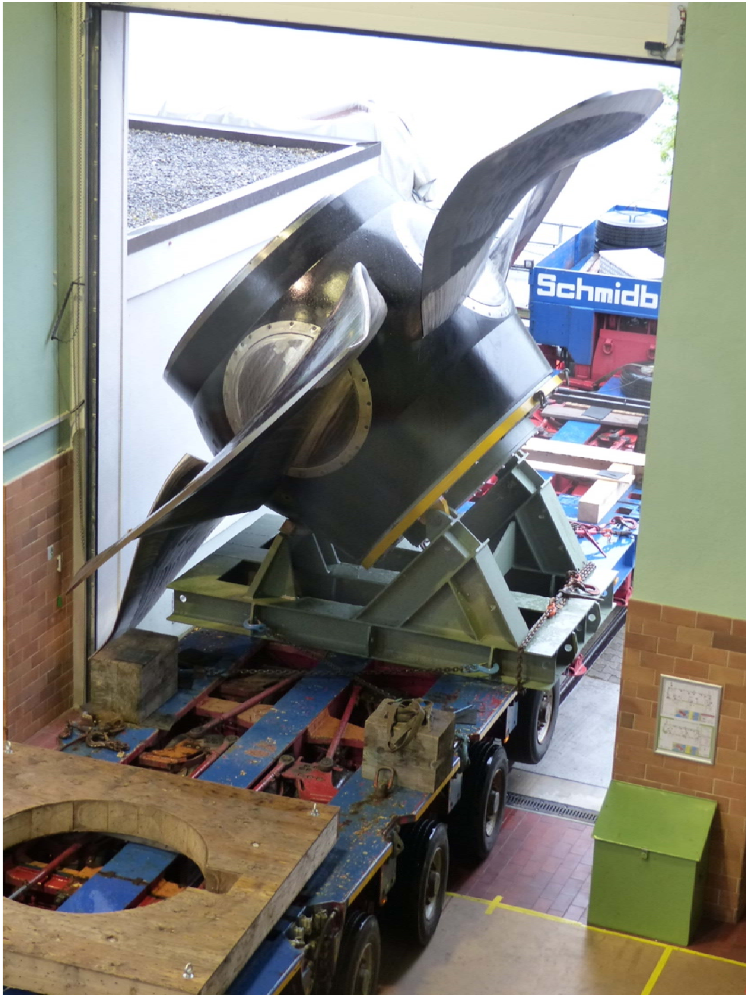
Bild: Laufrad Maschinengruppe 1 Einfahren ins Maschinenhaus
